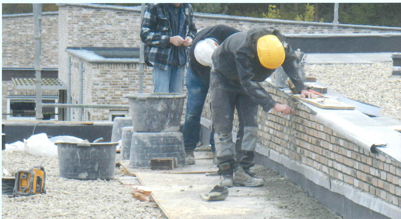
Foto 2: Er worden enkele platen underlayment op de ballastlaag gelegd voor de metselaar aan het werk gaat.
