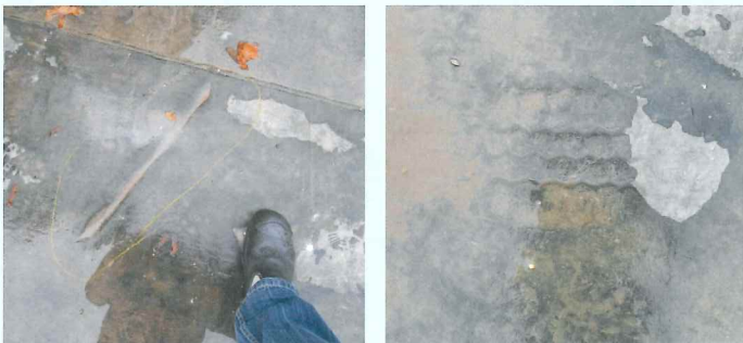
Foto 3 en 4: Maar liefst meer dan 100(!) beschadigingen in de dakbedekking worden aangetroffen. Variërend van ingedrukte bevestigingsmiddelen tot bandensporen van hoogwerkers en andere voertuigen.
