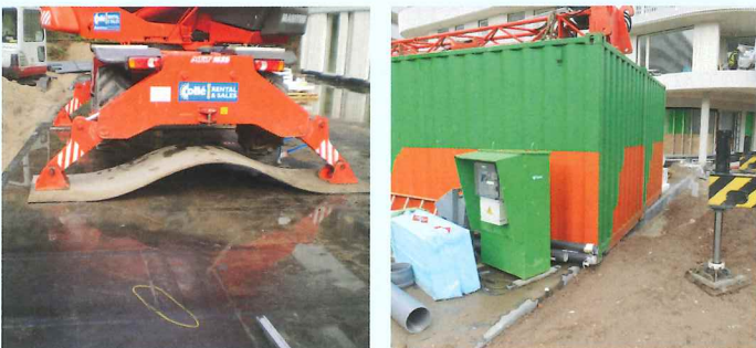
Foto 5 en 6: Het dak gebruikt als opslagplaats voor bouw materiaal/-materiael.
