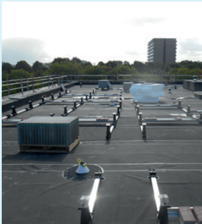
Foto 3: De valbeveiliging is niet meer bruikbaar na het plaatsen van de zonnepanelen.
